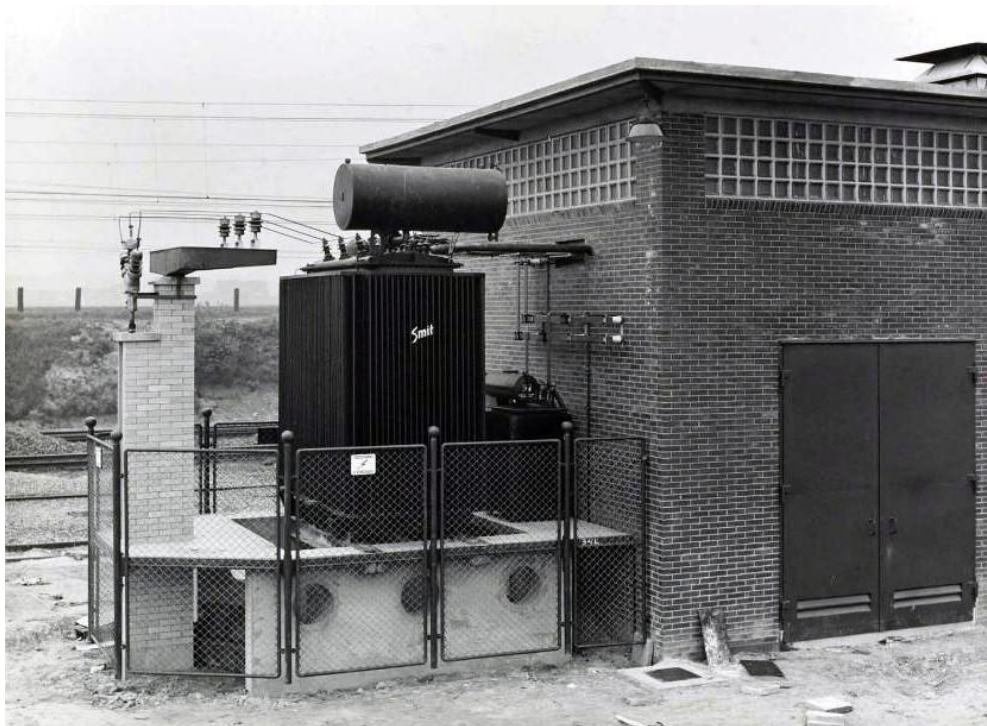
Figuur 416: Transformator bij station Sittard in 1949
